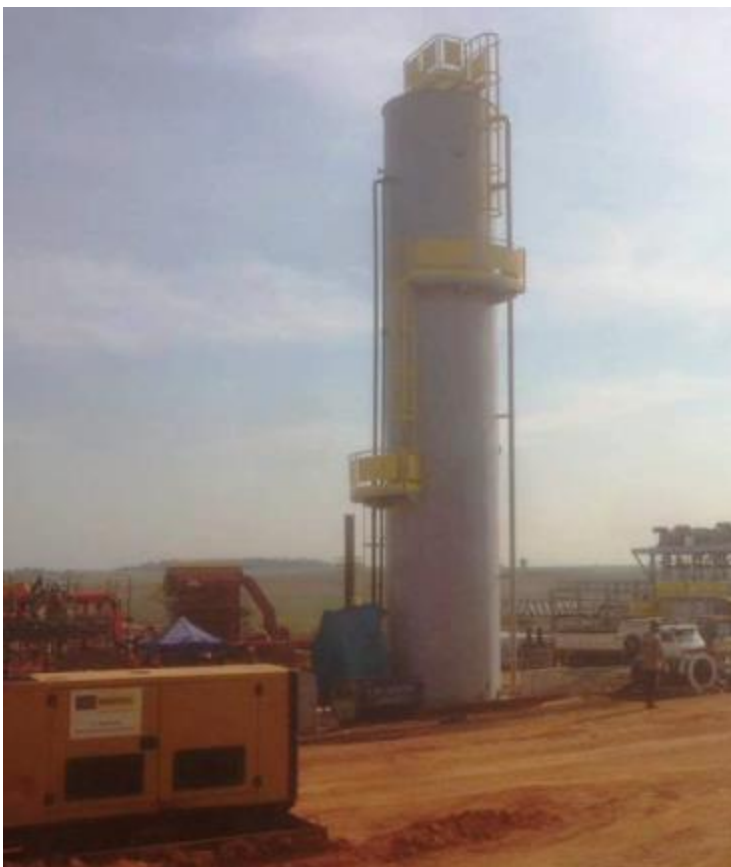
Bases Estaqueadas de Equipamentos
